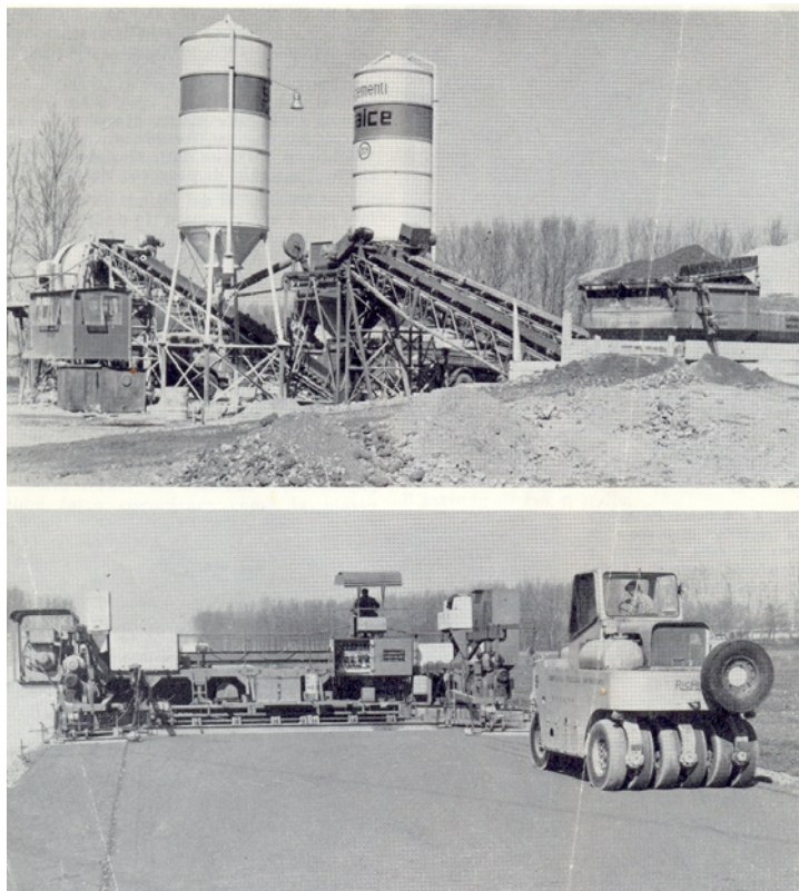
Фиг. 9.1. Смесителен център за приготвяне на циментопочвена смес и нейното разстилане и уплътняване.
